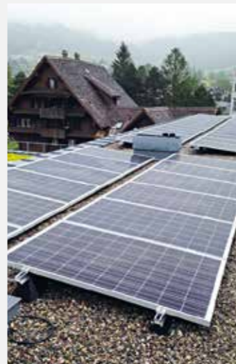
6431 Schwyz | Leistung 21,06 kWp Flachdach | Kies
