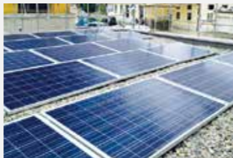
8620 Wetzikon | Leistung 6,24 kWp Flachdach | Kies
