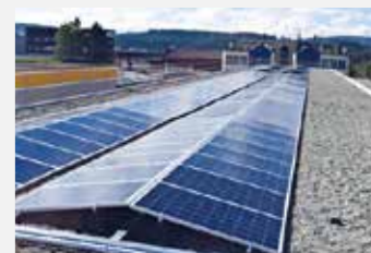
8625 Gossau | Leistung 70,72 kWp Flachdach | Kies
