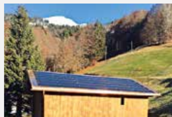
7220 Schiers | Leistung 7,2 kWp Schrägdach | Integriert
