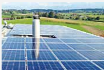
8625 Gossau | Leistung 19,5 kWp Schrägdach | Blechfalz
