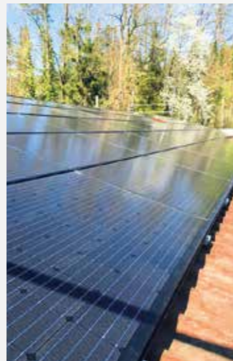
8340 Hinwil | Leistung 13,25 kWp Schrägdach | Ziegel
