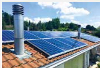
8624 Grüt | Leistung 9,62 kWp Schrägdach | Ziegel
