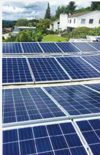
8624 Grüt | Leistung 13 kWp Flachdach | Kies
